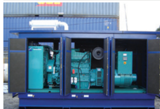
O Grupo Gerador carenado: na parte traseira, detalhe das tomadas.
