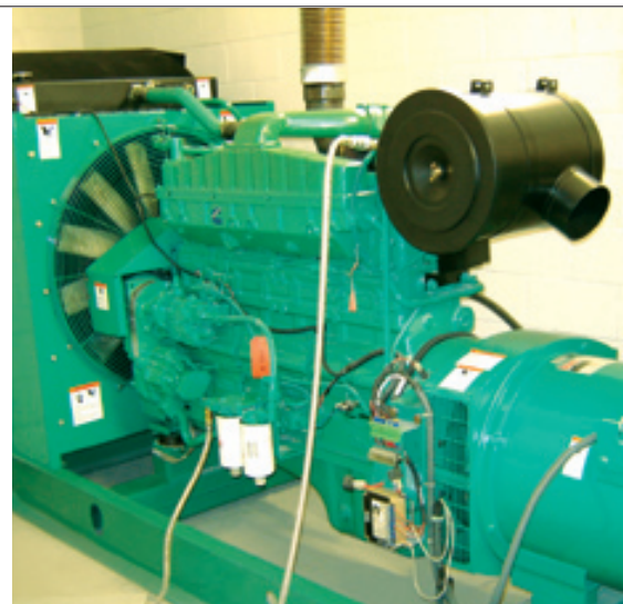
O Grupo Gerador Cummins instalado na nova loja da C&C.
